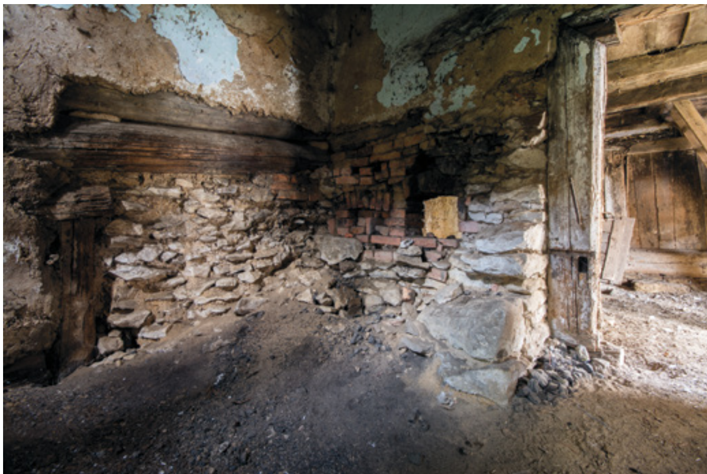
13. Destrukce topeniště ve světnici, pohled k východu, 2015, foto J. Kmošek. Destruction of the fire place in the sitting room, view towards east. Destruktion der Feuerstelle in der Stube, Blick zum Osten.
