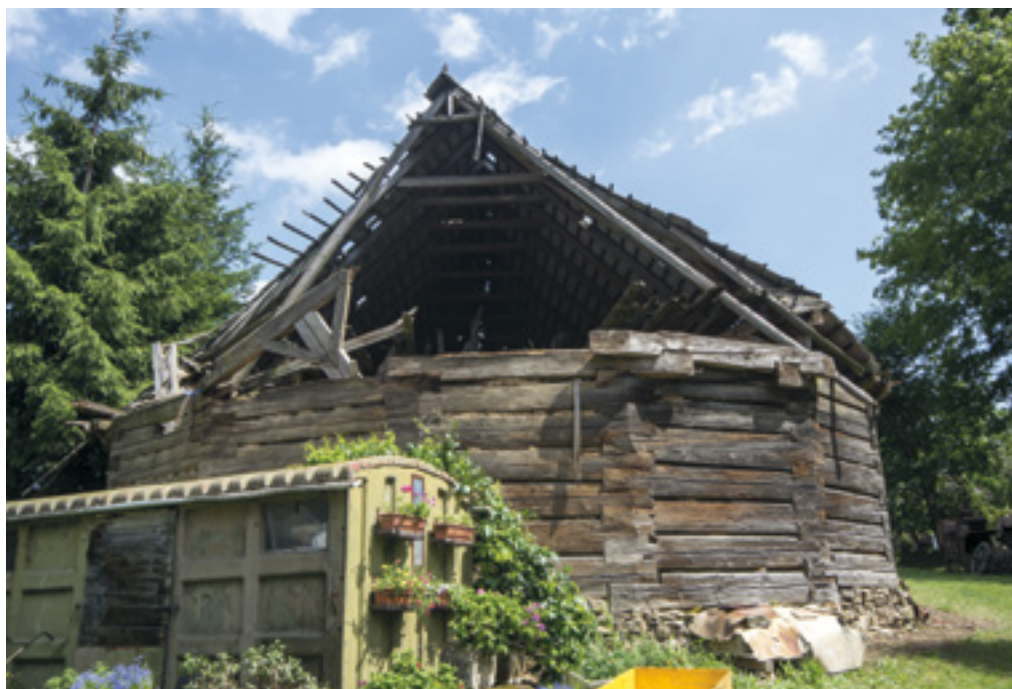
27. Západní polygon stodoly s destrukovanou částí krovu, 2015, foto J. Kmošek. Western polygon of the barn with a destroyed part of the roof truss. Westlicher polygonaler Abschluss der Scheune mit teilweise zerstörtem Dachstuhl.
