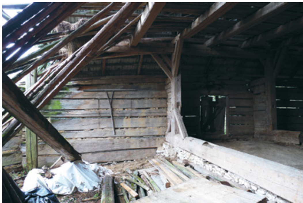
32. Západní přístodůlek s destruovaným krovem, 2015, foto Z. Křenková. Western threshed straw storage with a destroyed roof truss. Westliche Banse mit zerstörtem Dachstuhl.
