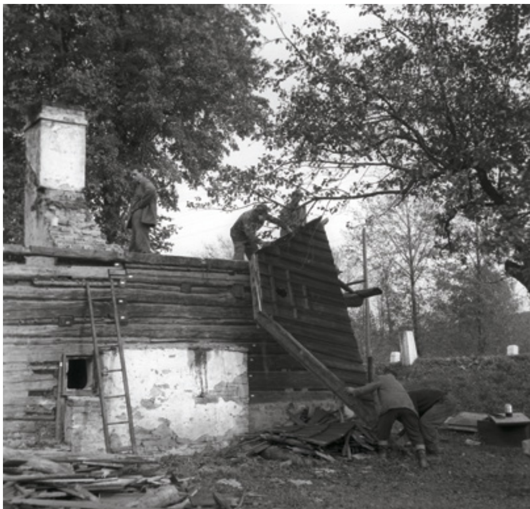
11. Chalupa z Valašské Polanky, v případě některých chalup probíhala demontáž konstrukcí v celku, snímání štítu objektu pod vedením Antonína Závady. 1967, foto M. Baďuříková, oddělení dokumentace VMP. Cottage from Valašská Polanka; the disassembly of some constructions was done in one piece in the case of certain cottages – removal of the gable under the supervision of Antonín Závada. Bauernhaus aus Valašská Polanka, im Falle einiger Bauernhäuser wurden ganze Konstruktionen abgetragen, Abbau der Giebelwand unter der Leitung von Antonín Závada.
