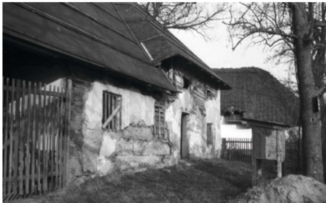
3. Rekonstrukce domu čp. 64 v Rymicích, 1982, foto J. Langer, Oddělení dokumentace VMP. Reconstruction of house No. 64 in Rymice. Rekonstruktion des Hauses Nr. 64 in Rymice.
