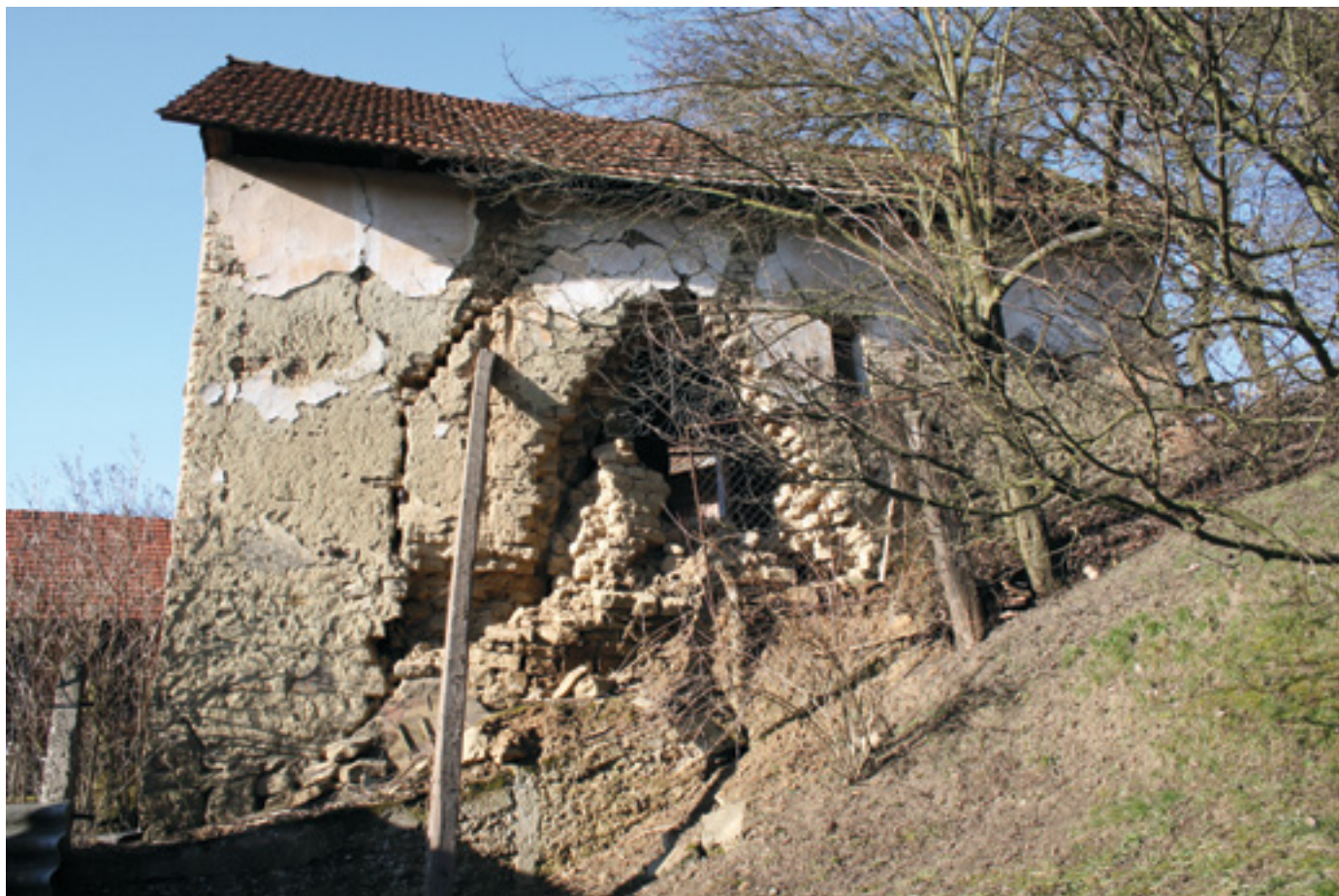
5. Destruovaná boční stěna výměnku před započítím obnovy, 2010, foto V. Říhová. Destroyed side wall of reservatum rusticum before the reconstruction. Zerstörte Seitenwand des Ausgedinges vor der Erneuerung.
