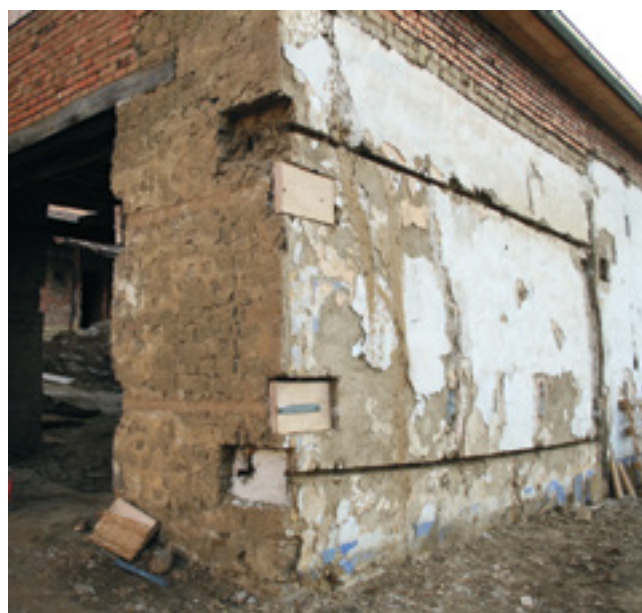
10. Detail instalace táhel při statickém zajištění obytného domu, 2011, foto V. Říhová. Detail of the installation of construction rods during the securing protection of the residential house. Detail der Anbringung von Zugstangen bei der statischen Sicherstellung des Wohnhauses.
