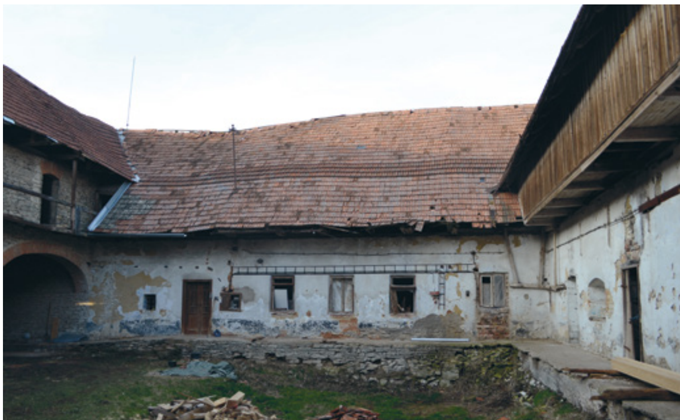
5. Severní stěna dvora, usedlost čp. 56 v Trstěnici, 2016, foto V. Kmošek. Northern wall of the courtyard, farmstead No. 56 in Trstěnice. Nordwand des Hofes, Bauernhof Hs.-Nr. 56 in Trstěnice.
