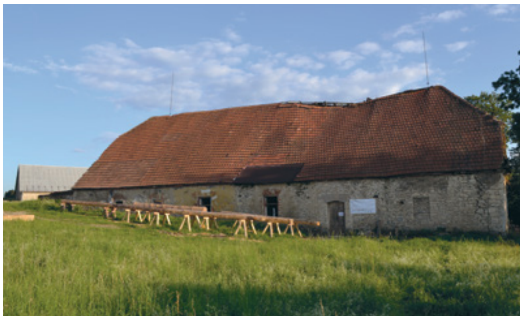
2. Severní stěna usedlosti čp. 56 v Trstěnici, 2016, foto V. Kmošek. Northern wall of farmstead No. 56 in Trstěnice. Nordwand des Bauernhofes Hs.-Nr. 56 in Trstěnice.
